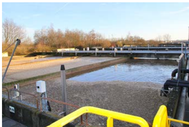
Zur Standortausrüstung gehört natürlich auch eine Biokläranlage.
