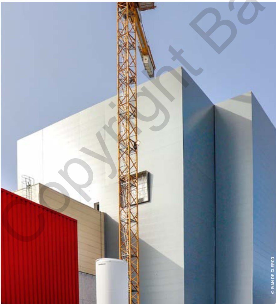
Die belgische Milchindustrie investiert weiter. Hier der neue Pulverturm von LDA in Recogne.
