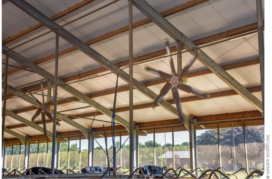
Das Stalldach ist isoliert und die Ventilatoren sind speziell angeordnet.
